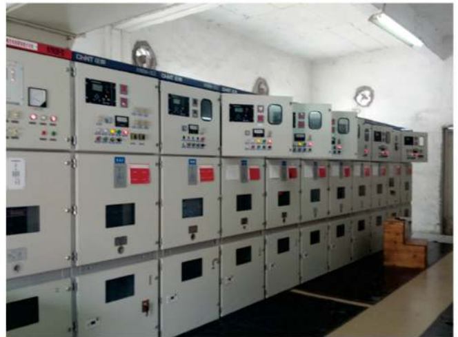
生产线中压配电室
